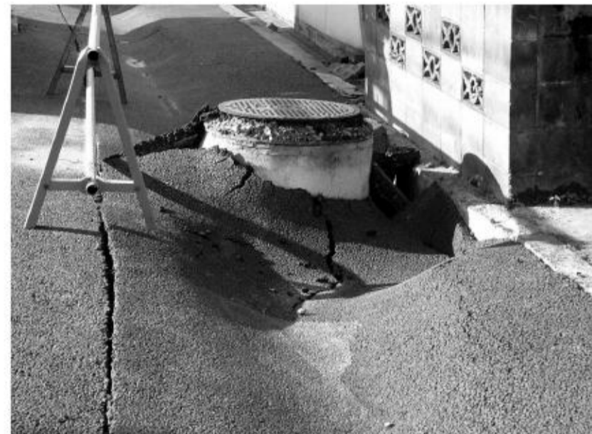
図8.2 浮き上がるマンホール (長岡市中沢、筆者撮影)
