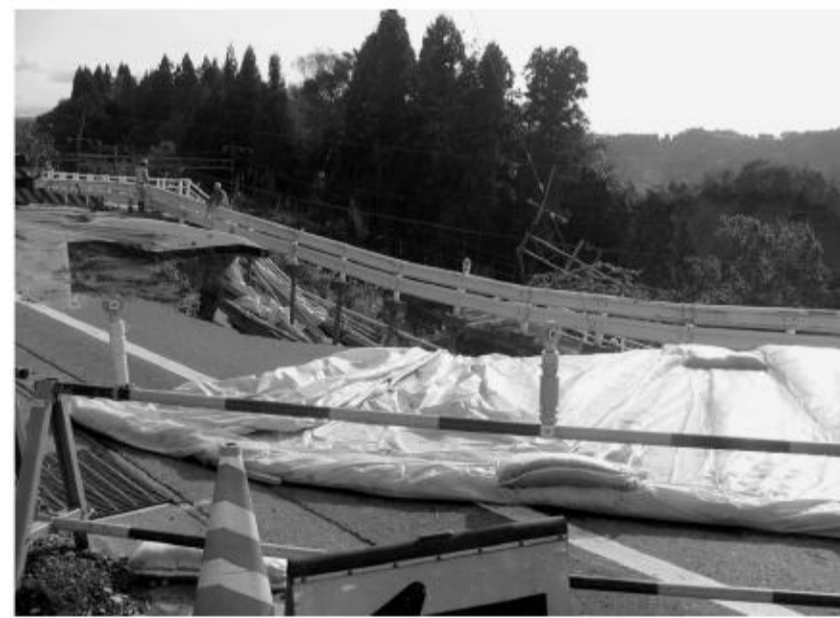
図8.1 国道17号線大規模崩落現場（川口町天納、筆者撮影）
